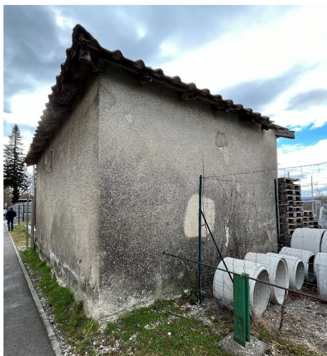
Slika 6: Manjši zapuščen objekt (cca v km 15+885)
